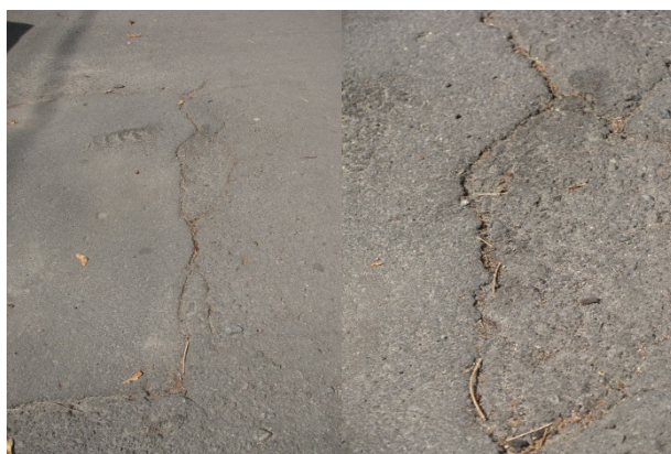
Рисунок 1 – Развитие трещин по контуру карты ямочного ремонта
