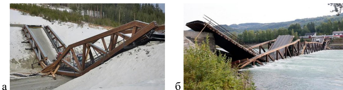
Рис. 1.8 – Зруйнований дерев'яний шляхопровід (а) та міст (б) [2]
