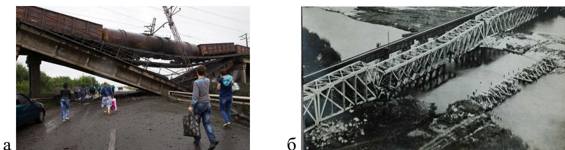
Рисунок 3 – Повністю зруйнований міст, прогонові будови якого придатні для використання при відновленні (а, б) [2]
