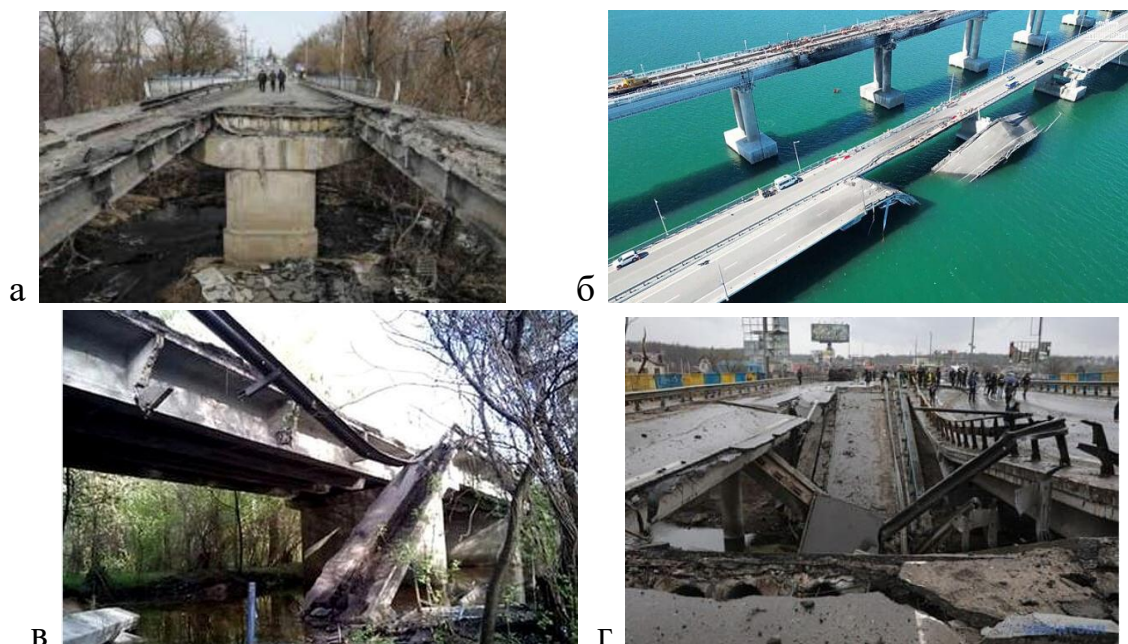
Рисунок 10 – Мости із руйнуванням окремих елементів прогонової будови (а-г) [1-3]
