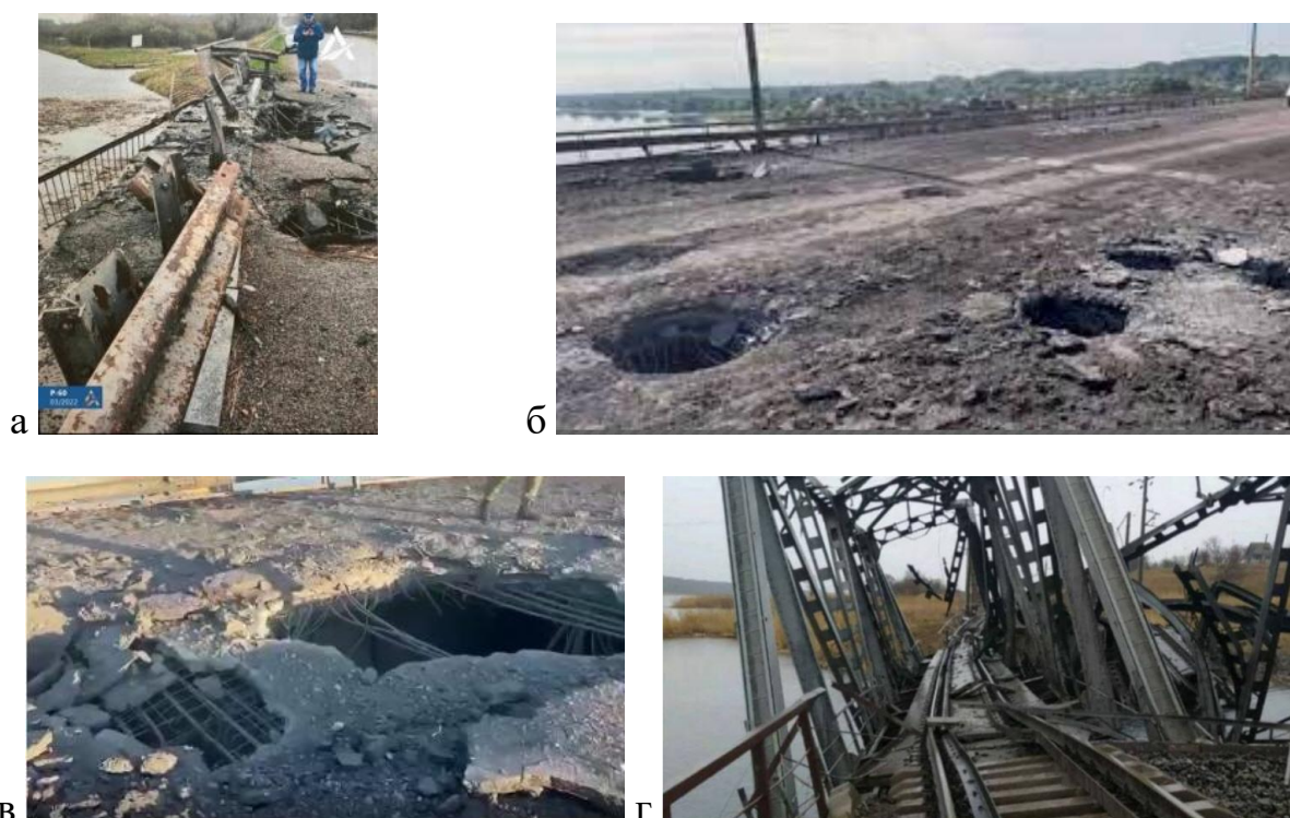
Рисунок 11 – Пошкодження мостів, що не викликали обвалення прогонової будови (а-г) [1-3]
