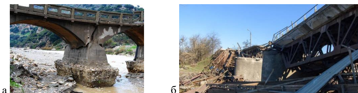
Рисунок 1 – Руйнування опори: а – кам'яної; б – бетонної [2]
