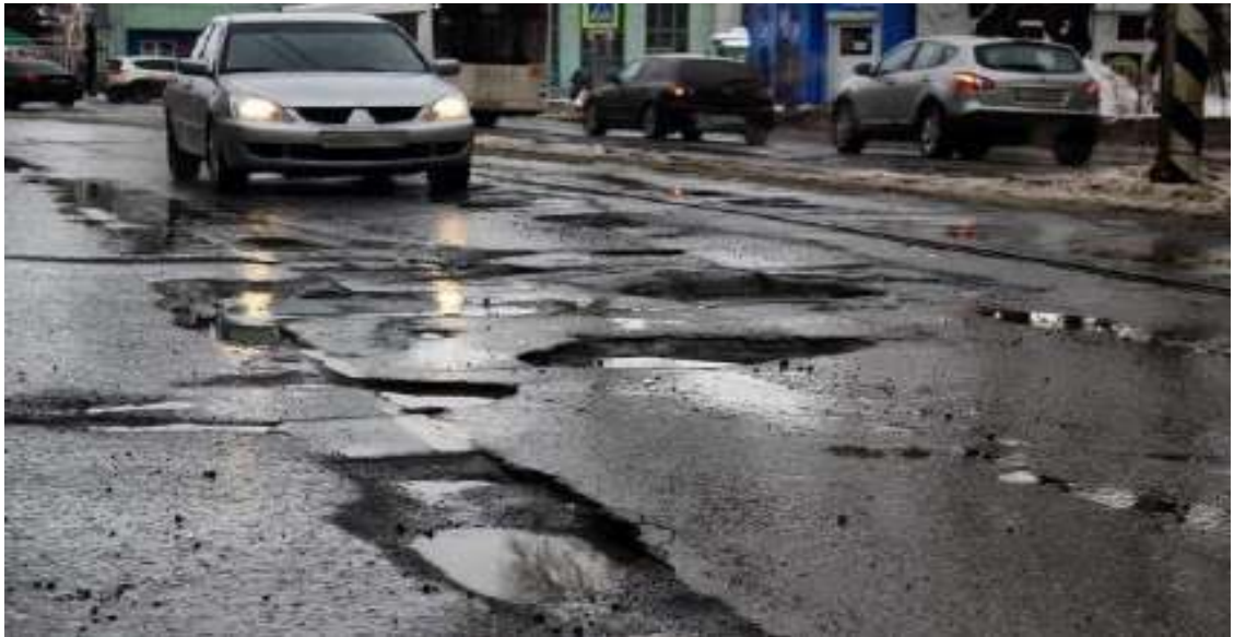
Рис. 3 - Незадовільні дорожні умови
