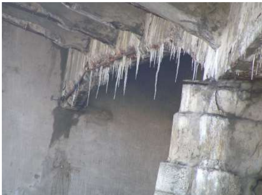
Рисунок 2 – Фильтрация воды на Купеческом мосту
