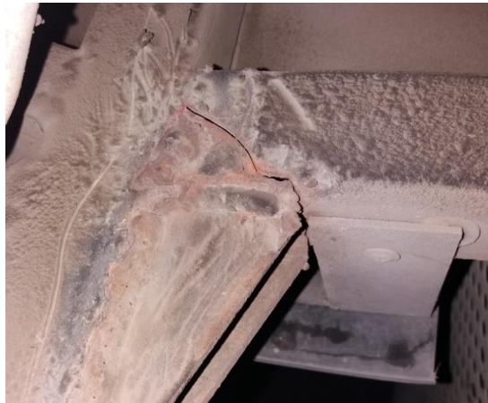
Рисунок 4 – Тріщина труби каркасу основи кузова в передній частині
