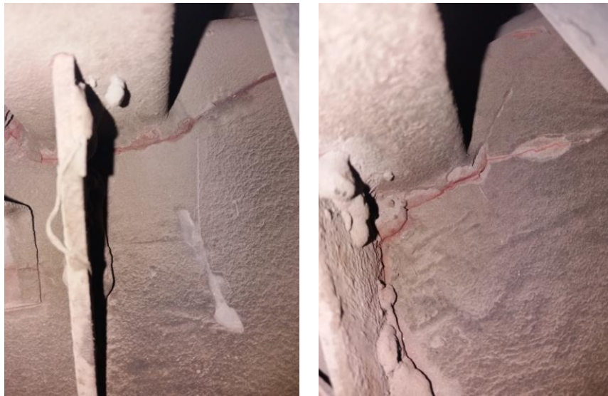
Рисунок 3 – Тріщини правого лонжерона перерізом 140x60x3 мм
