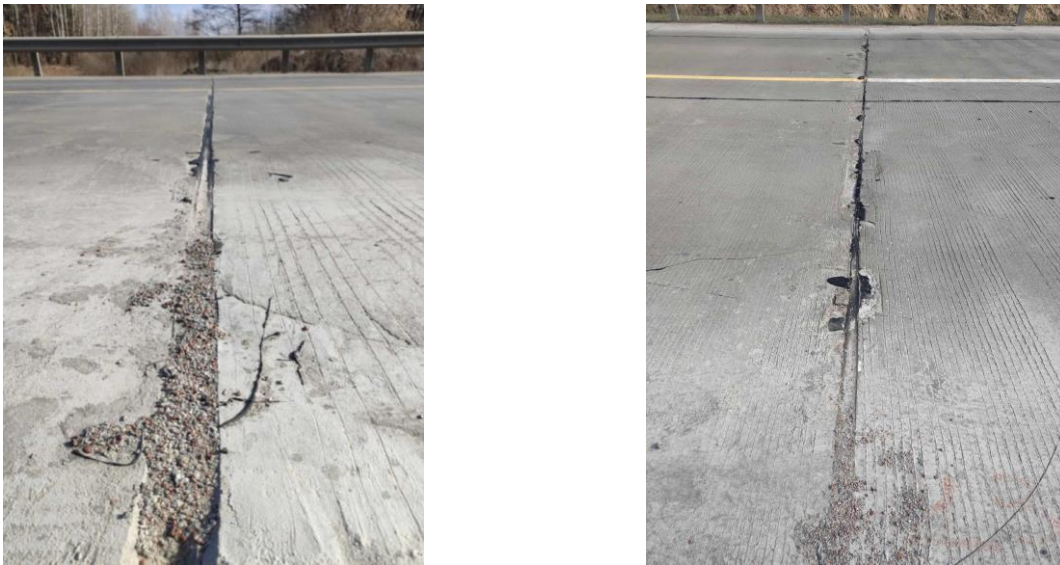
Рисунок 5 – Зруйновані кромки цементобетонних плит
