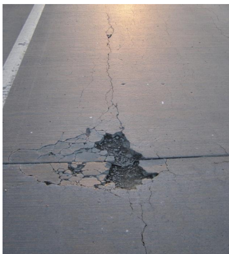
Рисунок 1 – Руйнування у вигляді вибоїн з сіткою тріщин в зоні перехрещення деформаційного шва стиску та поздовжньої тріщини
