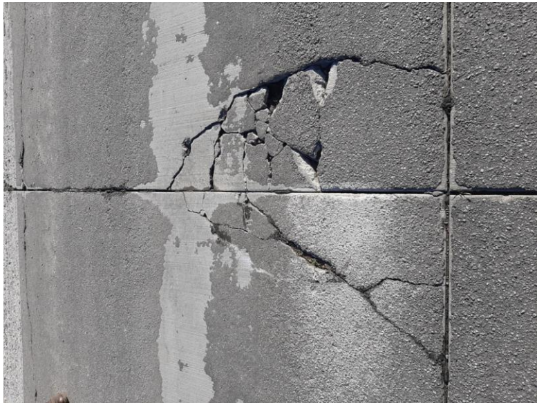
Рисунок 3 – Проломи, які утворилися у кутах суміжних цементобетонних плит
