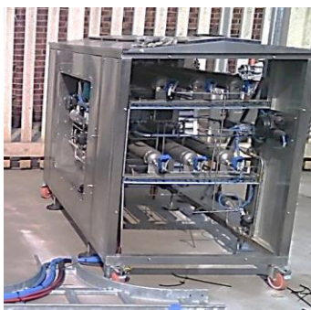
Рис. 5.17. Одноступінчастий металогідридний ТСК (див. також рис. 5.15), що використовує 87 кг інтерметаліду Ti_{0.65}Zr_{0.35}(Cr,Fe,Mn,Ni)_2 в шести металогідридних контейнерах (генераторах-сорберах); час повного циклу компримування 60 мін. Компресор працює на аффінажному заводі “Impala Platinum Refineries” (м. Спрінгс, ПА) з жовтня 2015 р. [5, 6, 10, 11]
