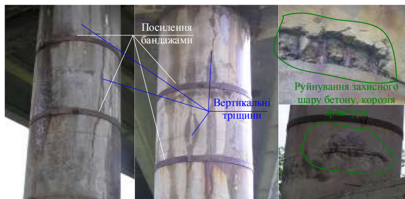
Рисунок 1. Руйнування оболонок стовпів проміжних опор мосту через р. Лопань а/д Київ-Харків-Довжанський км 480+600 в м.
