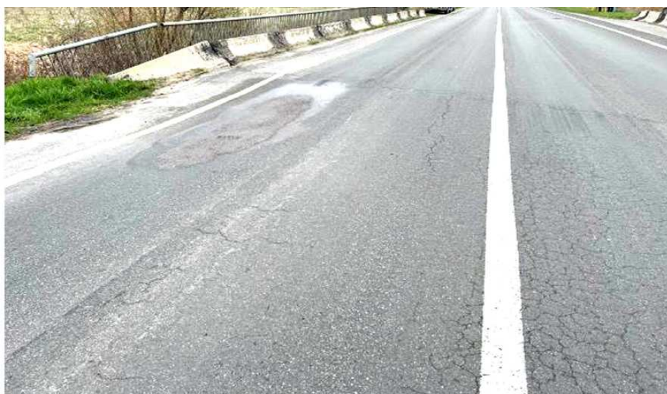
Рисунок 4 – Сітка тріщин в асфальтобетонному покритті, завдяки вимову ґрунту утворилася яма перед опорою.
