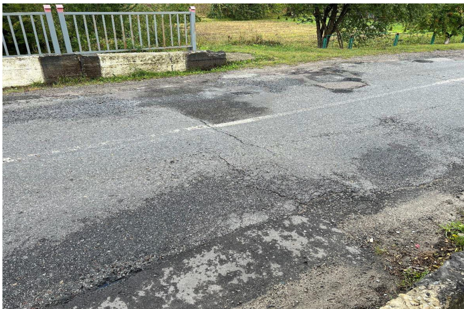
Рисунок 3 – Ділянка сполучення малого мосту з насипом. Латки, тріщини в покритті, локальні просідання основи
