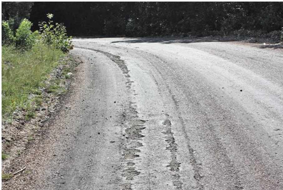
Рисунок 1 – Знос дорожнього покриття
