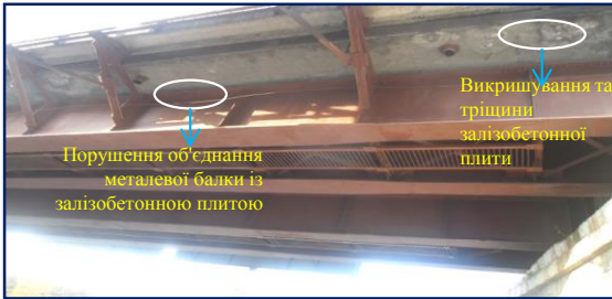
Рис. 1. Характерні пошкодження сталезалізобетонних мостів у процесі експлуатації
