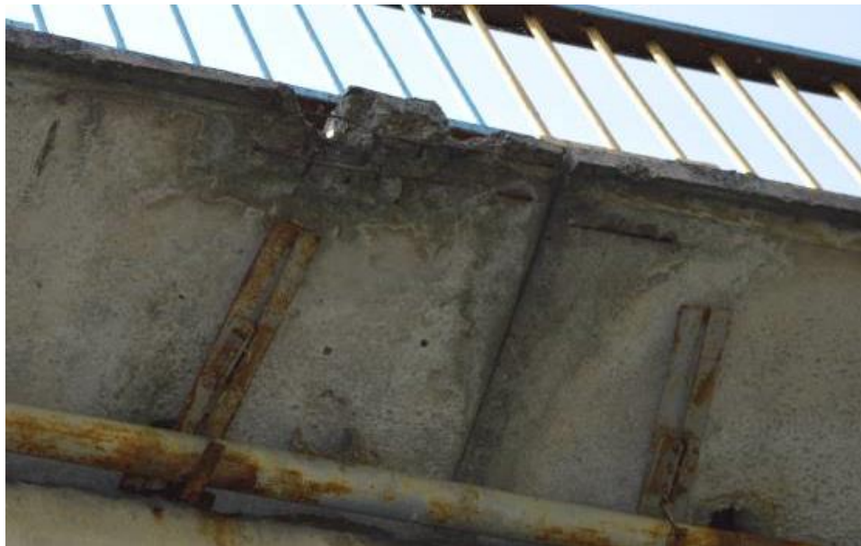
Рисунок 2 – Руйнування захисного шару бетону з оголенням і корозією арматури тротуарних блоків
