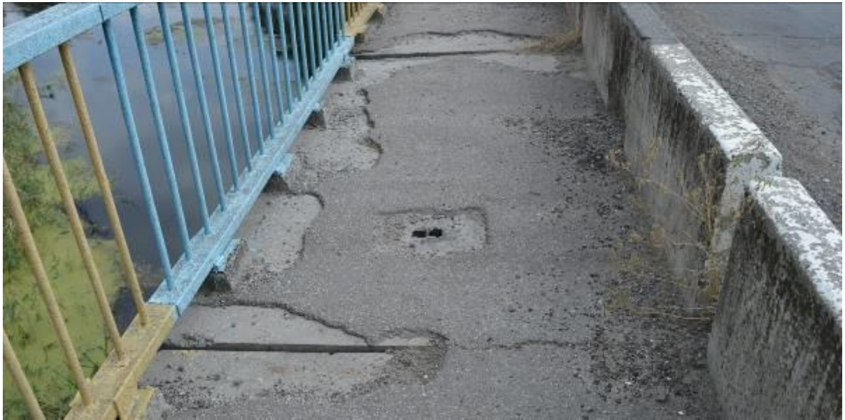
Рисунок 3 – Руйнування асфальтобетонного покриття на тротуарах
