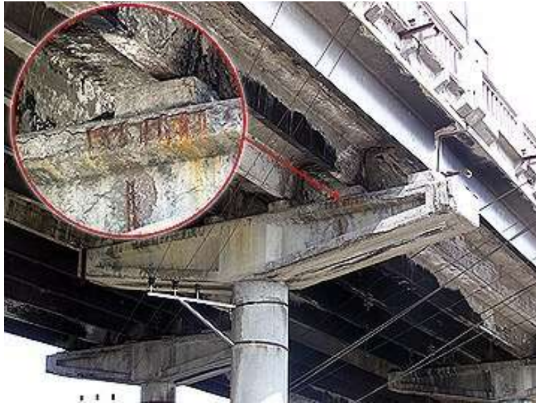
Рисунок 1 – Дефекти залізобетонних конструкцій в ході експлуатації
