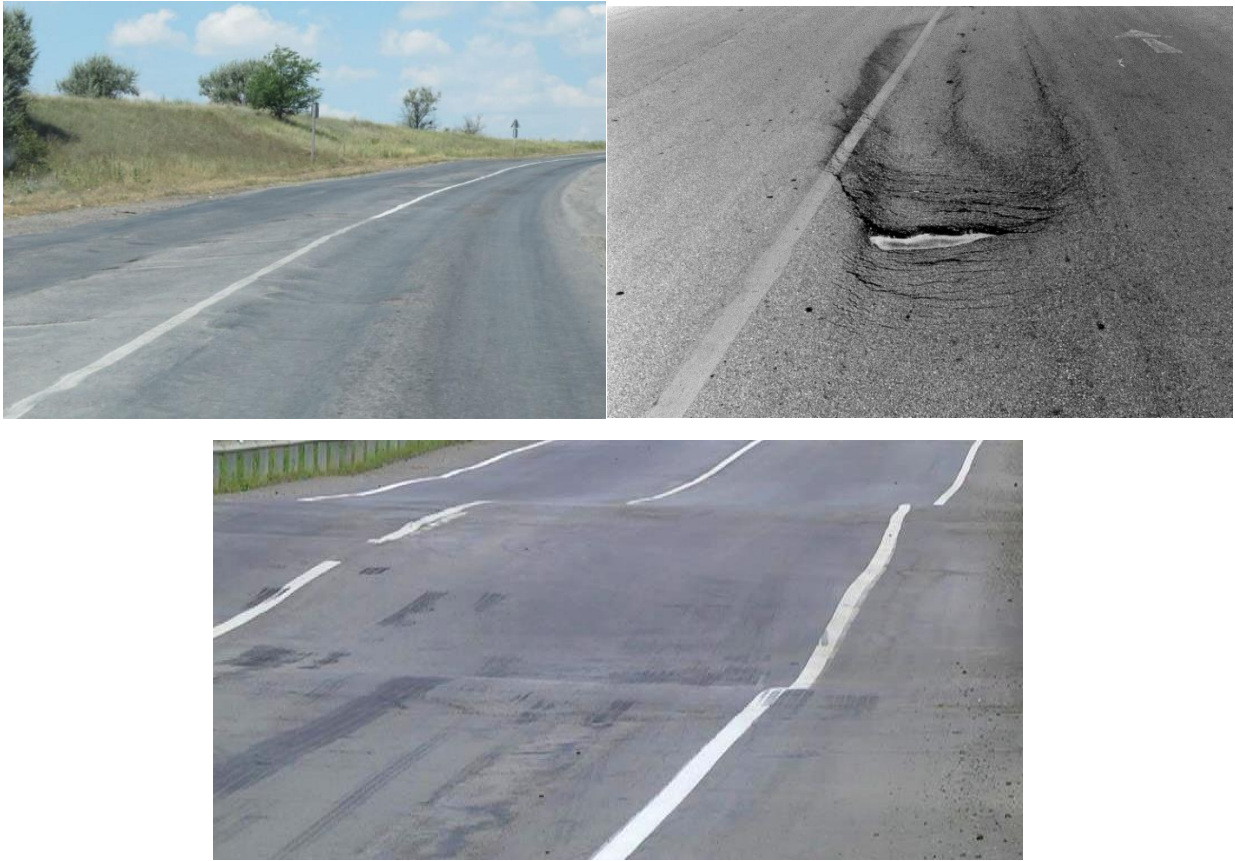
Рисунок 1 – Деформації асфальтобетонного покриття
