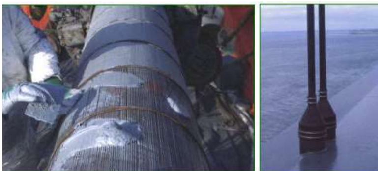
Рисунок 1 – Антикорозійний захист канатних елементів мосту Сторебелт
