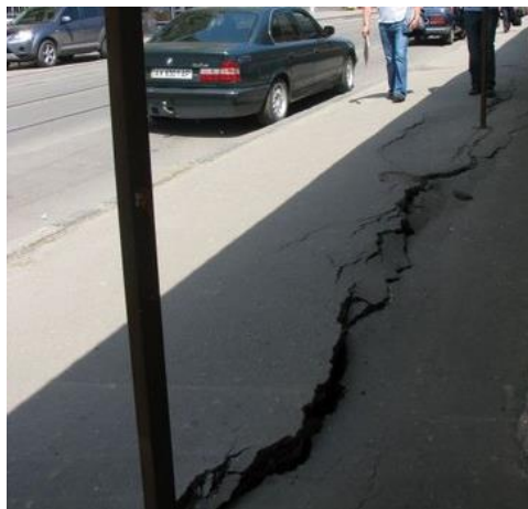
Рисунок 1 – Тріщина на тротуарі поблизу котловану (м. Харків)
