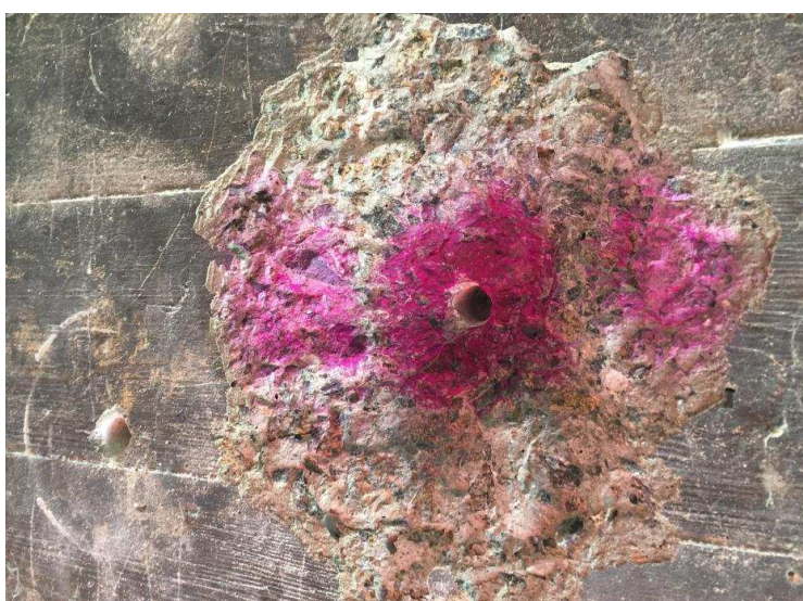
Рисунок 3 – Місце руйнування бетону після випробування методом відриву зі сколюванням на балці мосту через р. Сіверський Донець біля с. Старий Салтів.
