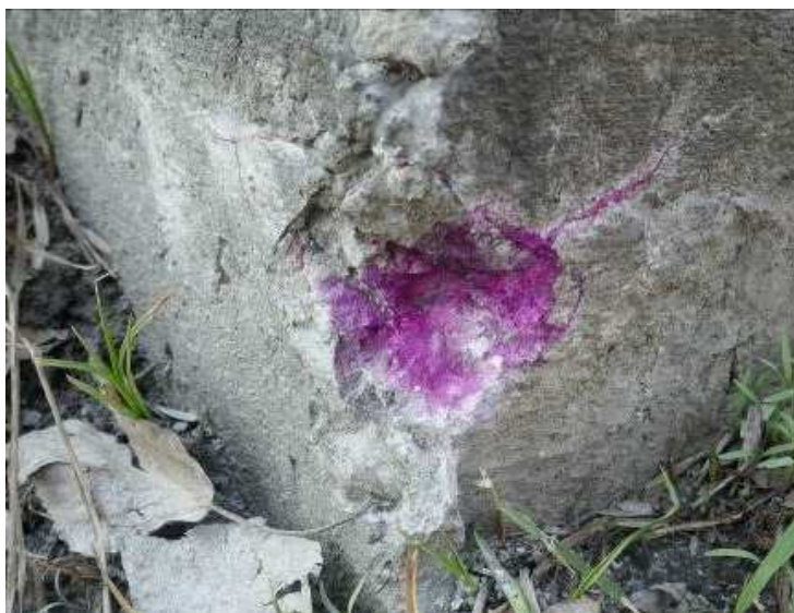
Рисунок 1 – Обробка однопроцентним розчином фенолфталеїну бетону відколотого кута фундаменту старого Карпівського пішохідного мосту у м. Харків через р. Лопань
