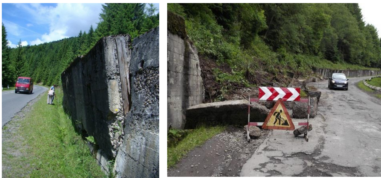
Рисунок 1.3 – Руйнування підпірної стінки на перевальній ділянці автомобільної дороги Міжгір'я -Колочава-Буштино (Синевирський перевал)
