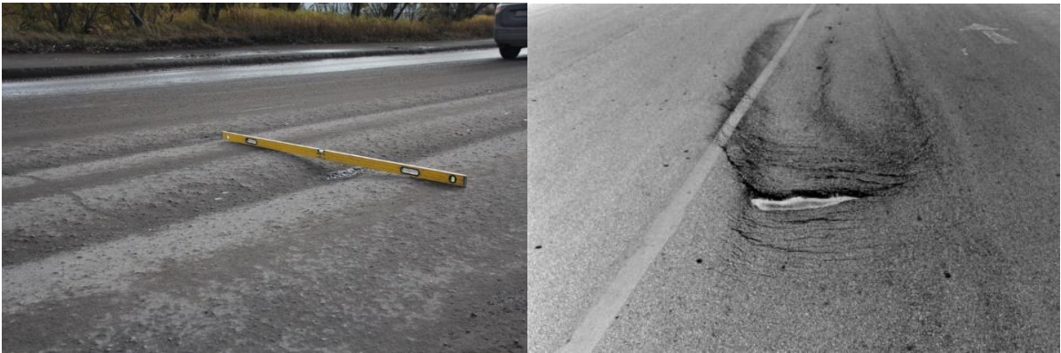
Рисунок 4 – Деформація поперечного профілю дорожнього полотна уздовж лінії накату
