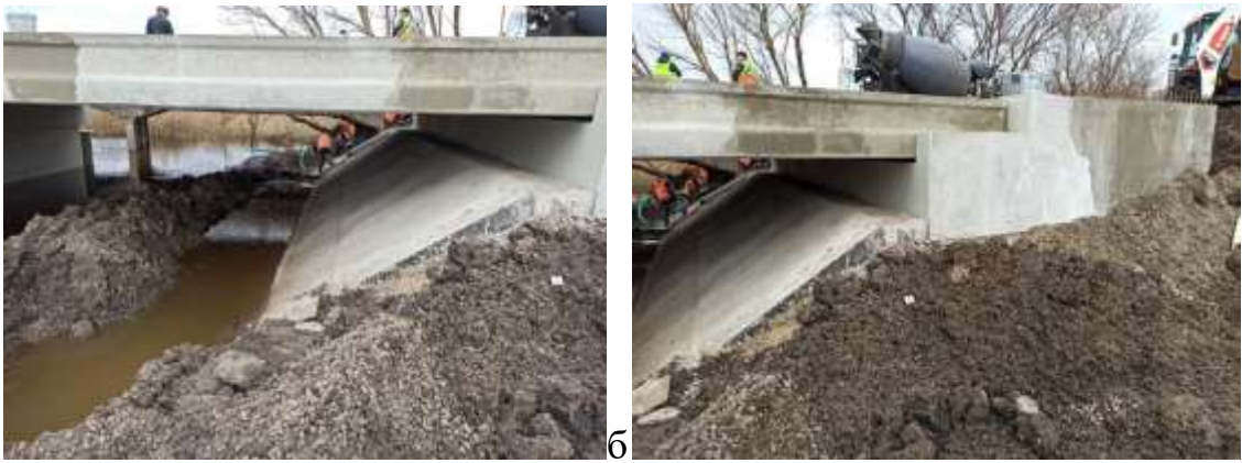
Рис. 3.6 – Частина виконаного укріплення конусу насипу монолітним бетоном по шару щебеню (з боку с. Вербівка)
