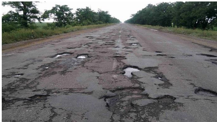
Рисунок 3 – Состояние дорожного покрытия
