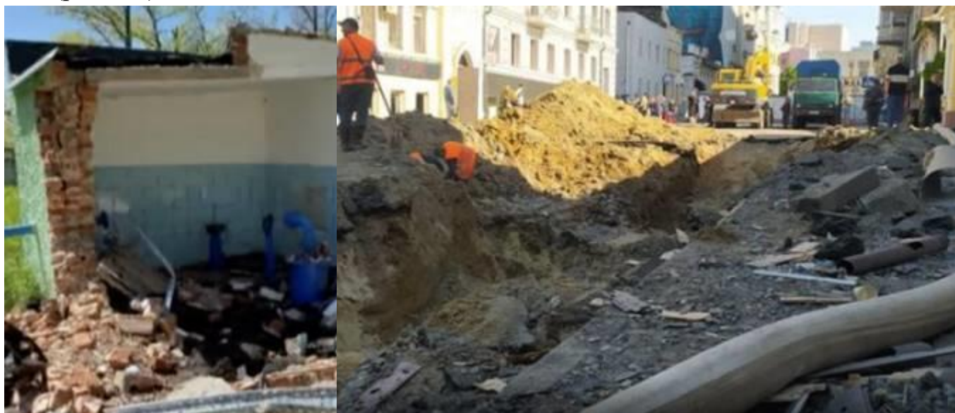
Рисунок 3.4 – Руйнування систем водопостачання в наслідок російського обстрілу
