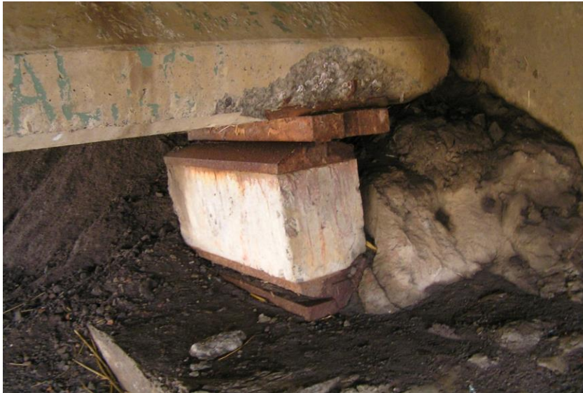
Рисунок 3 – Зсув балки відносно опорної частини і як наслідок її руйнування
