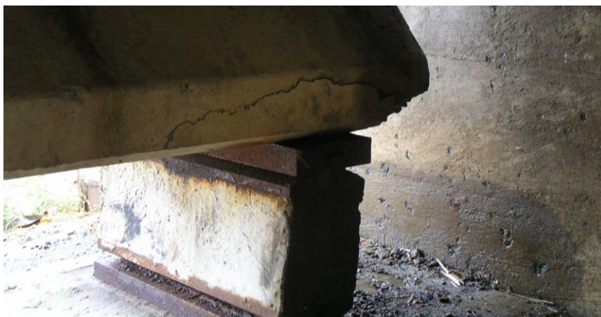
Рисунок 2 – Руйнування балки при поганій роботі опорної частини
